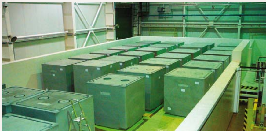
V sklade upravených vláknotbetónových kontajnerov v FS KRAO
