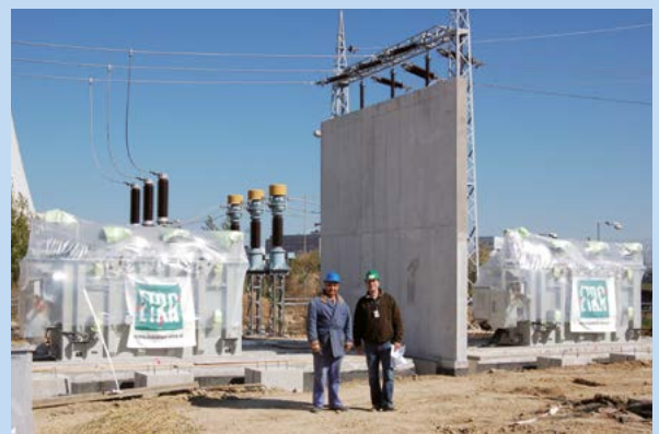
Nové transformátory budú onedlho sfunkčnené.
