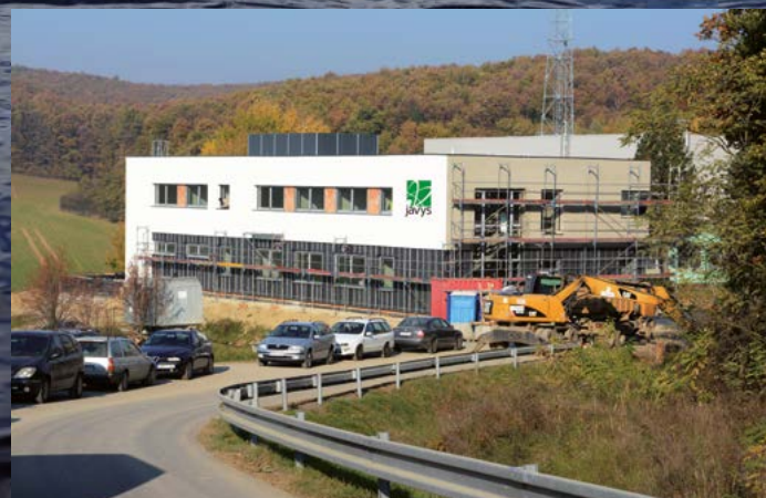
Súčasťou zariadenia je administratívny objekt s informačným centrom.
