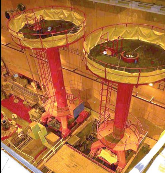
Zavážacie stroje v reaktorovej sále pred vyradovaním
