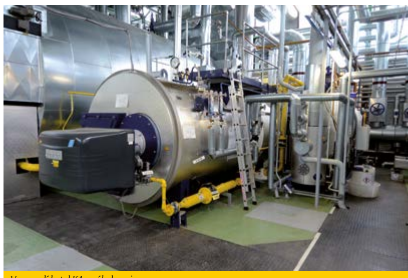
V popredí kotol K4 v nábehovej a rezervnej kotolni s príslušenstvom.
