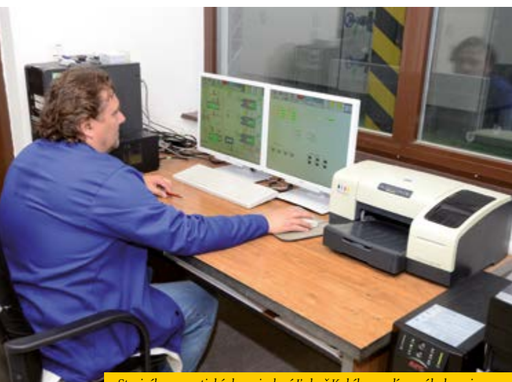
Strojník energetických zariadení Ľuboš Kubík vo veľine nábehovej a rezervnej kotolne počas riadenia prevádzky kotlov.
