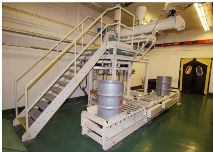
Experimentálna cementační linka KWU slúžila na cementáciu kvapalných rádioaktívnych odpadov z prevádzky JE V1.
