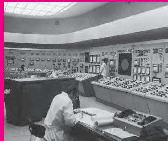
Na blokovej dozorni.
