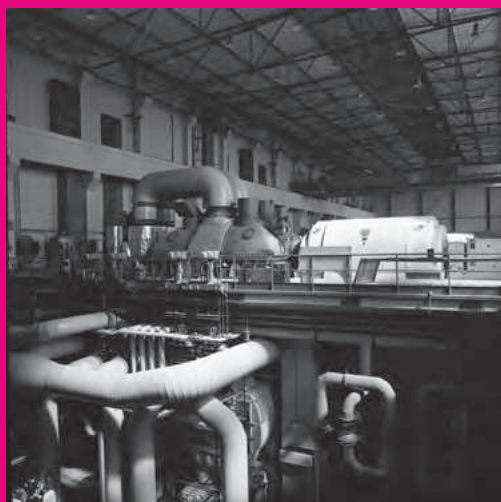
V strojovni pracovali 3 turbíny s výkonom po 50 MW.
