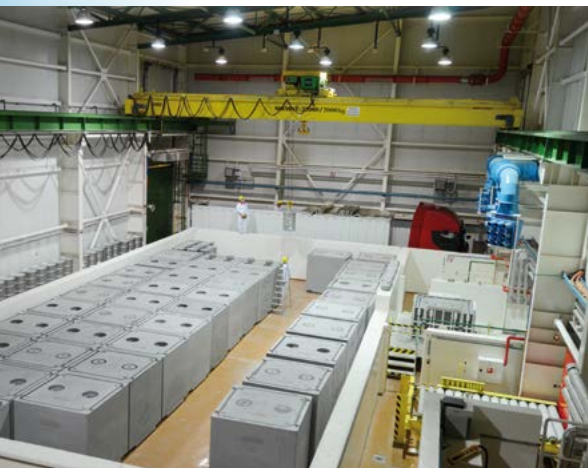
Vláknobetónové kontajnery s rádioaktívnymi odpadmi
