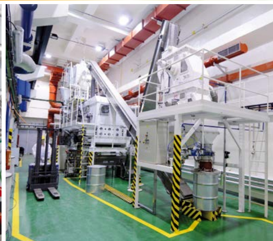
Pracovisko spracovania vzduchotechnických filtrov
