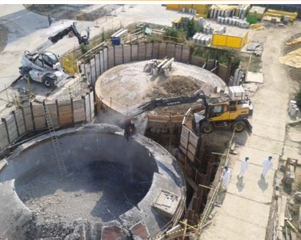
Vyradovanie vonkajších skladovacích nádrží kvapalných RAO
