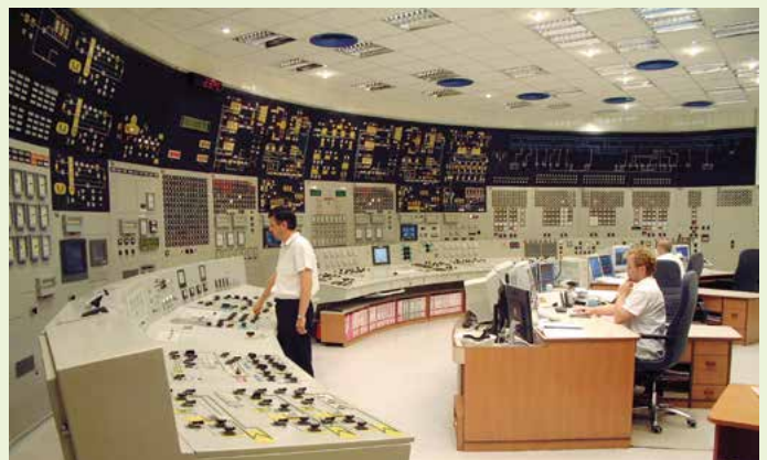
Bloková dozornia 2. bloku počas prevádzky.
