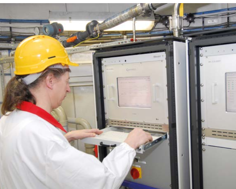
Technik radiačnej bezpečnosti Jaroslav Holec kontroluje prevádzkový stav rádiologického monitora objemovej aktivity aerosólov vo vzdušnej vypúšťanej cez ventilačný komín V1.
