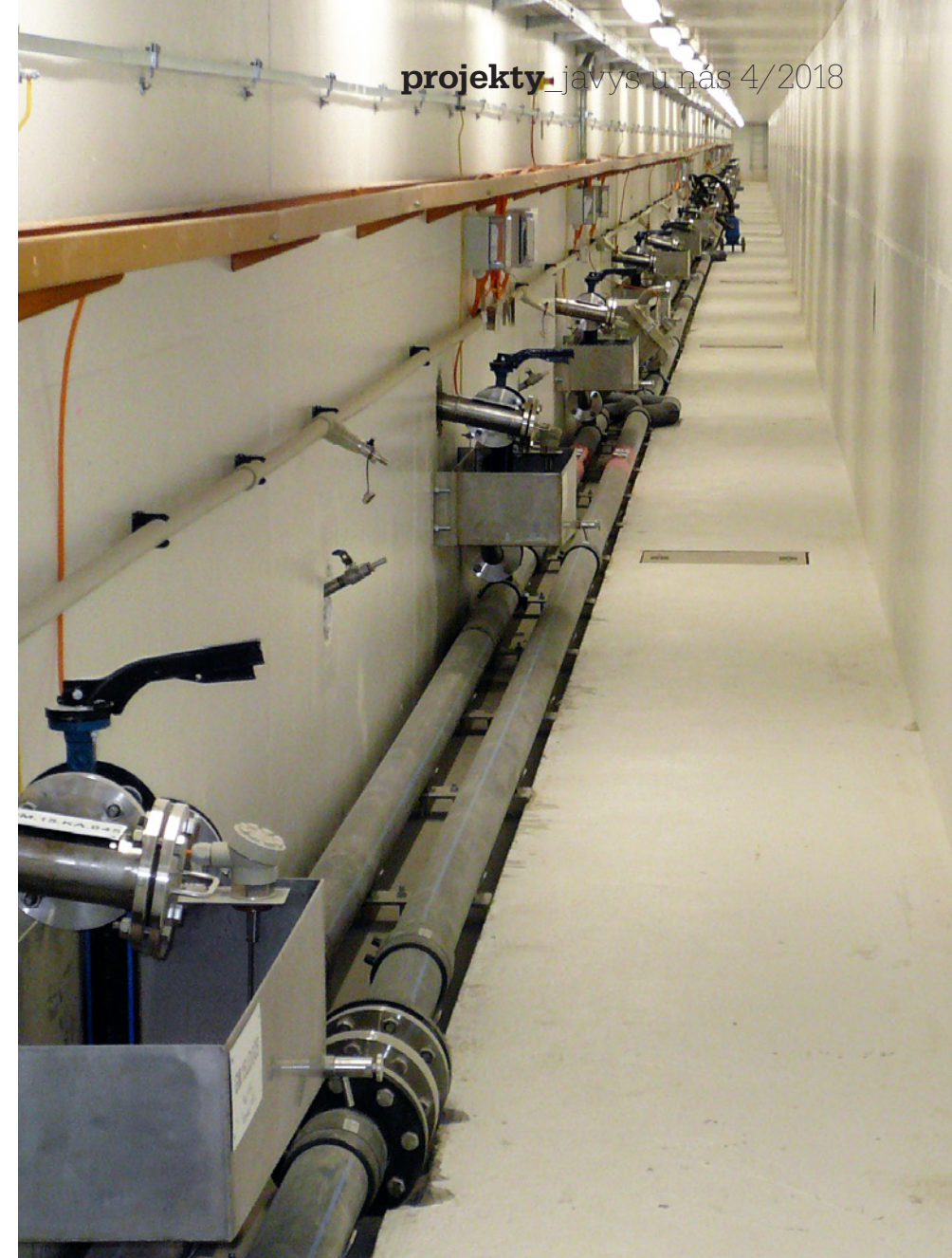
Monitorovacia štôľňa na kontrolu a monitorovanie drenážnych vôd.
