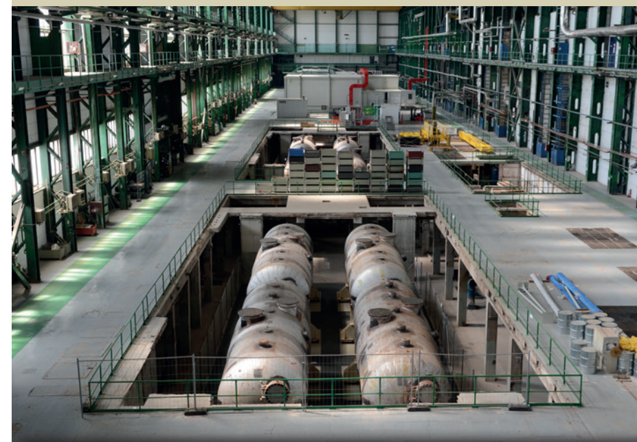
Parogenerátory umiestnené v strojovni, v pozadí pracovisko suchej fragmentácie parogenerátorov.
