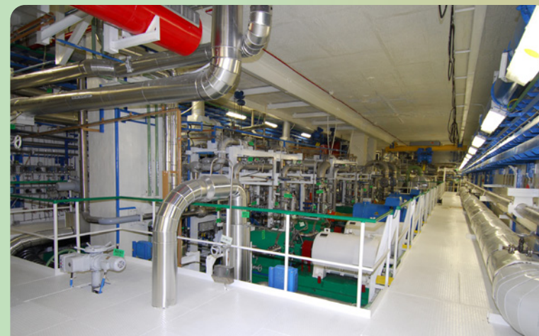
Miestnosť čerpadiel a výmenníkov havarijného chladenia reaktorov (bórný uzol) pred demontážou ...
