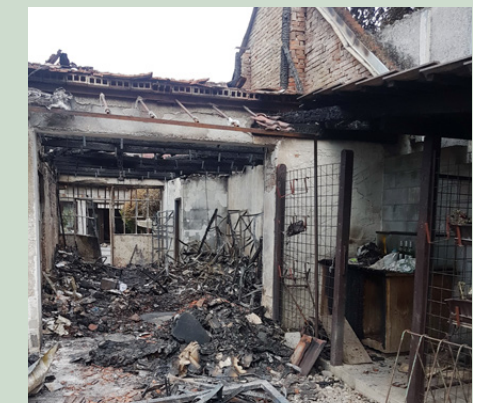
Pohľad na torzo poškodeného domu manželov Bubánových. Foto: Archív rodiny Bubánovej
