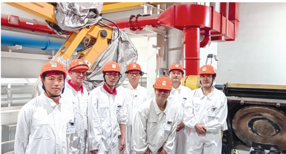
Kórejskí odborníci na pracovisku na pretavovanie kovových rádioaktívnych odpadov
